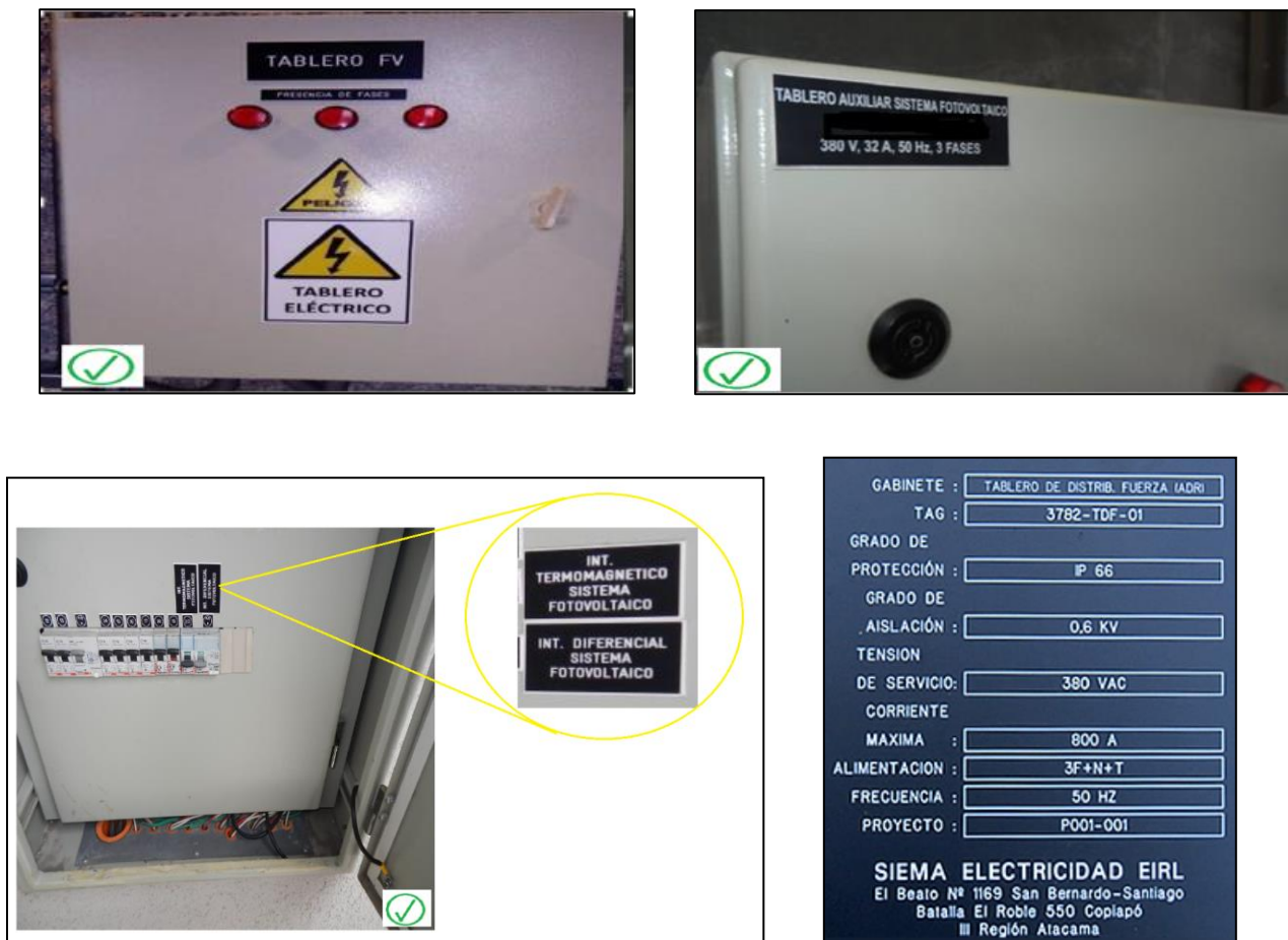
Figura 3-21: Rotulos en tableros electricos
