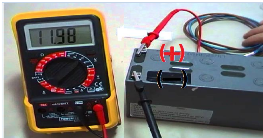
Figura 3-32: Medicion de tension baterias
