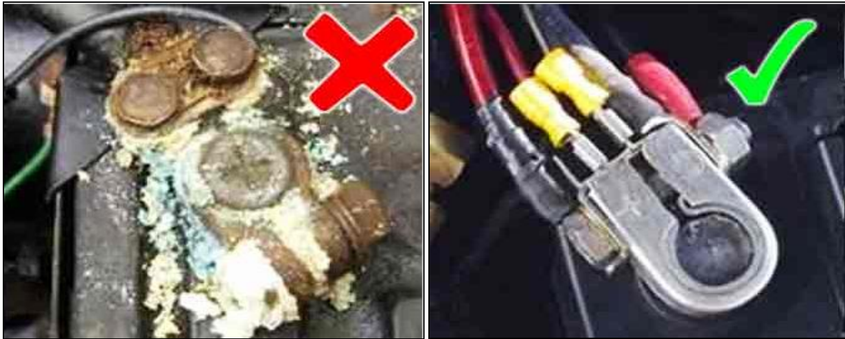
Figura 3-35: Bornes en buen y mal estado
