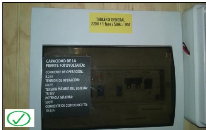
Figura 3-8: Placa de identificación tablero electrico UG
