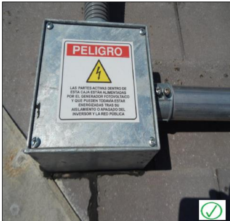
Figura 3-7: Tablero caja de conexión
