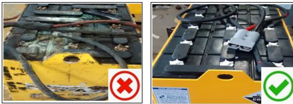
Figura 3-33: Conductores en buen y mal
